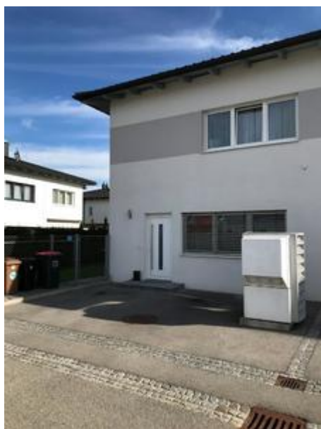
Doppelhaushälfte mit Luftwärmepumpe Günskirchen
