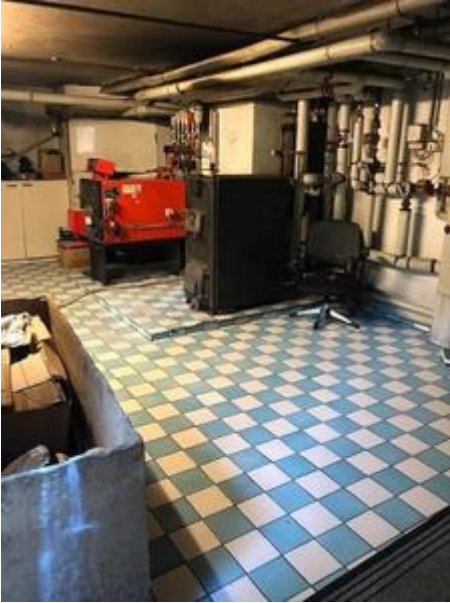
Heizraum Ölbrenner und Festbrennstoffheizung MFH Pichl b. Wels
